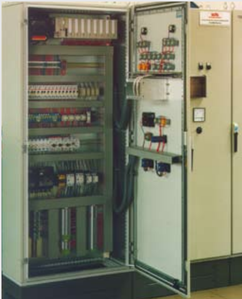
Schaltschrank (mit Innenansicht)
